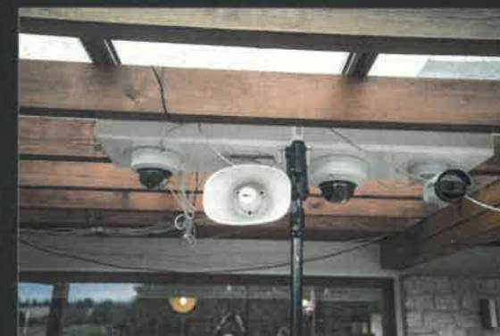
Kamerové systémy dnes dokážou rozpoznat, zda je pracovník dostatečně vybaven třeba pro vstup na staveniště
